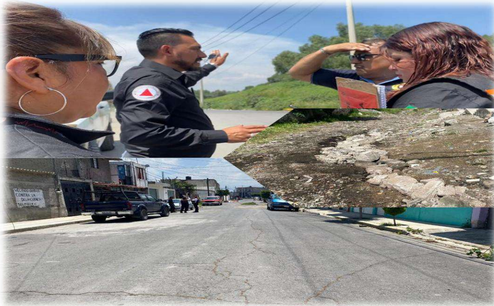
Fotografía 1: Inestabilidad de laderas Fuente: Protección Civil y Heroico Cuerpo de Bomberos Valle de Chalco Solidaridad
