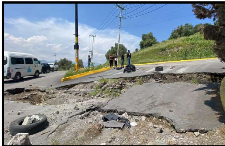
Fotografía 3. Fuente: Protección Civil y Heroico Cuerpo de Bomberos Valle de Chalco Solidaridad. Este tipo de agrietamiento es común observarlo en la zona lacustre. Las grietas son discontinuas y casi siempre paralelas entre sí, afectan tantas casas, banquetas, y pavimento.
