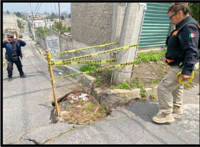
Fotografía 1. Fuente: Protección Civil y Heroico Cuerpo de Bomberos Valle de Chalco Solidaridad. El hundimiento del suelo, debido a la extracción de agua subterránea o la naturaleza del terreno, también puede afectar la estabilidad de las laderas.
