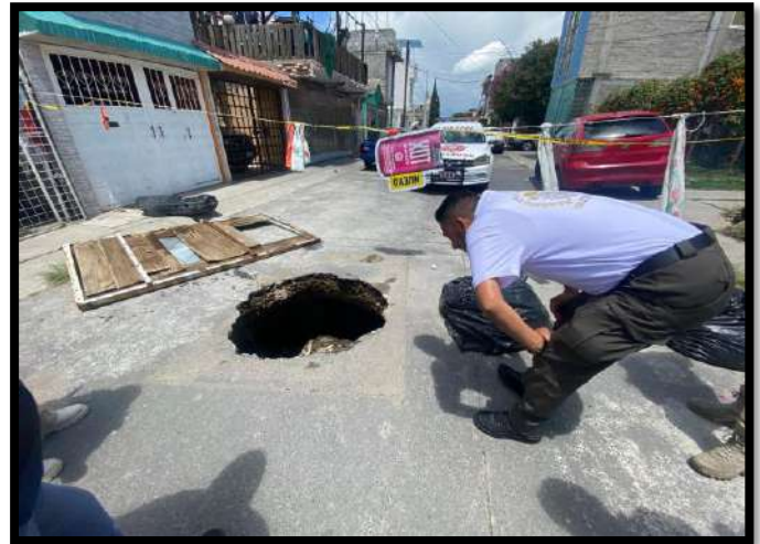
Fotografía 2. Fuente: Protección Civil y Heroico Cuerpo de Bomberos Valle de Chalco Solidaridad. En temporadas de lluvias estas grietas y oquedades se han manifestado, una de la razón es porque en esos puntos atraviesa una falla geológica.
