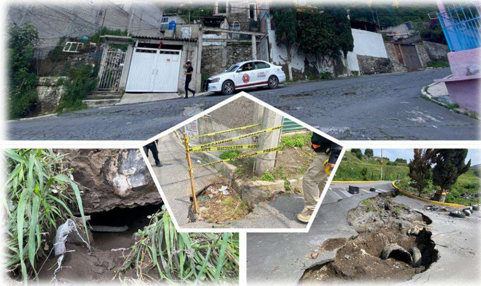
Fotografía 1: Hundimientos y subsidencia del suelo Fuente: Protección Civil y Heroico Cuerpo de Bomberos Valle de Chalco Solidaridad
