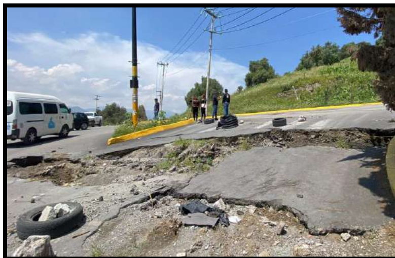
Fotografía 3. Fuente: Protección Civil y Heroico Cuerpo de Bomberos Valle de Chalco Solidaridad. Este tipo de agrietamiento es común observarlo en la zona lacustre. Las grietas son discontinuas y casi siempre paralelas entre sí, afectan tantas casas, banquetas, y pavimento.
