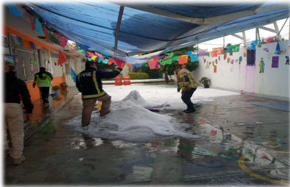
Fotografía 3: Techado colapsa por lluvia y granizo en Jardín de Niños Juan Ruiz de Alarcón, octubre del 2021. Valle de Chalco Solidaridad Fuente: Protección Civil y Heroico Cuerpo de Bomberos Valle de Chalco Solidaridad.
