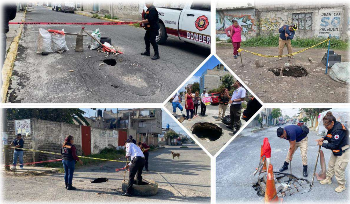
Fotografía 1: Socavones y hundimientos asociados a fallas, cavidades subterráneas, filtraciones, colapso de drenajes y extracción de agua en el municipio. Fuente: Protección Civil y Heroico Cuerpo de Bomberos Valle de Chalco Solidaridad
