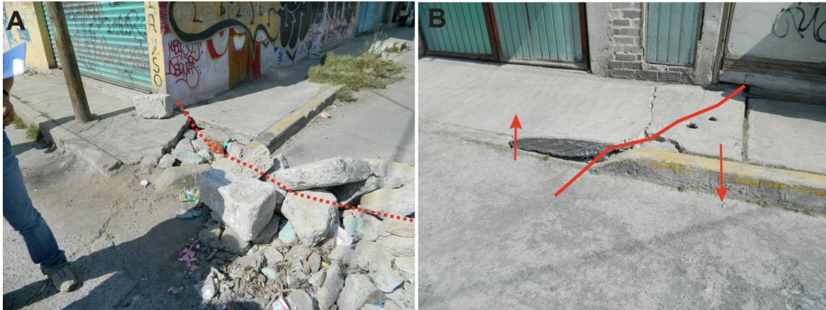
Imagen 13 Agrietamiento en la zona baja de la zona lacustre del municipio de Valle de Chalco Solidaridad. La población cubre con escombros el ligero (desde 2, 5 hasta 20 cm) desnivel del terreno. B) Se muestra el movimiento relativo relacionado con las grietas por extracción de agua.
